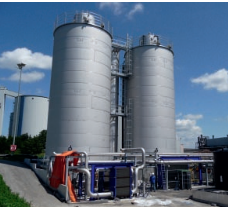
Nieuwe methaanreactoren in Dinteloord
